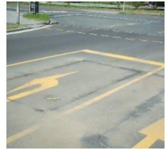
Das Bild zeigt Induktionsschleifen an einer Kreuzung.
