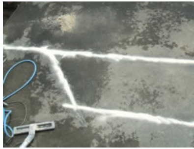
Nach dem Einlegen des Drahtes für die Induktionsschleife in die Nut wird diese "versiegelt".
